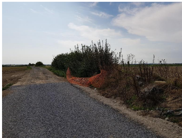
Le balisage de la haie en limite d'emprise de voirie, au sud-est de E15 est présent, mais dégradé.
